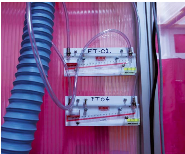
Exemple de manomètres à colonne de liquide inclinée utilisés dans les INB. © J.-L. Dolmaire/CEA
